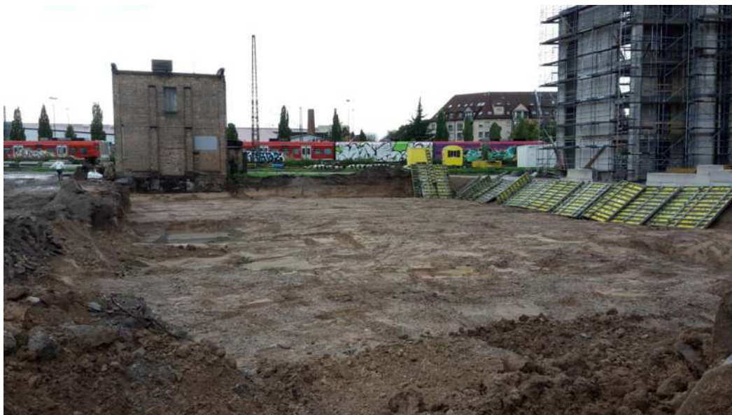
Abb. 4-1 Blick aus NW über die Baugrube nach Erreichen des Planums; li die Gebäude des 1. Bauabschnitts, im Hintergrund das ehem. Farben- und Lacklager (09.11.2022).
